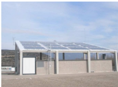
G- Instalación fotovoltaica de 25 kWp
