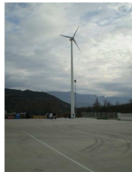
G- Aerogenerador 20 kW tipo full-converter
